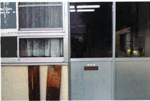
第一小学校（グラウンド側職員室サッシ）
